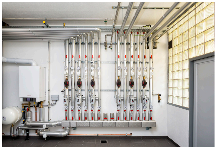
Verteilleitungen der neuen Heizungsanlage. (Foto: Fiehn Gebäudeautomation GmbH)
