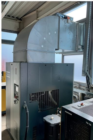
Druckluftkompressor mit Wärmerückgewinnung. (Foto: Gutbrod Fenster und Türen GmbH & Co. KG)
