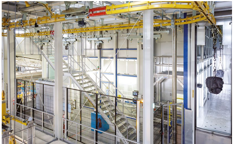
Lackieranlage im Betrieb
