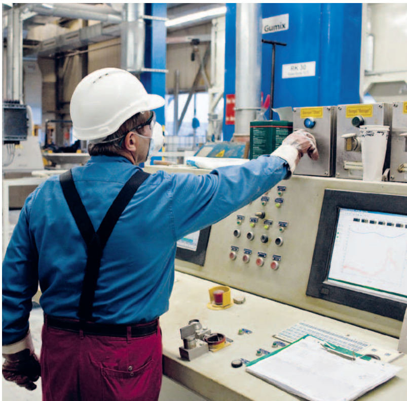
Steuerpult eines Mischaggregates in den Konfektionierbetrieben, © VCI
