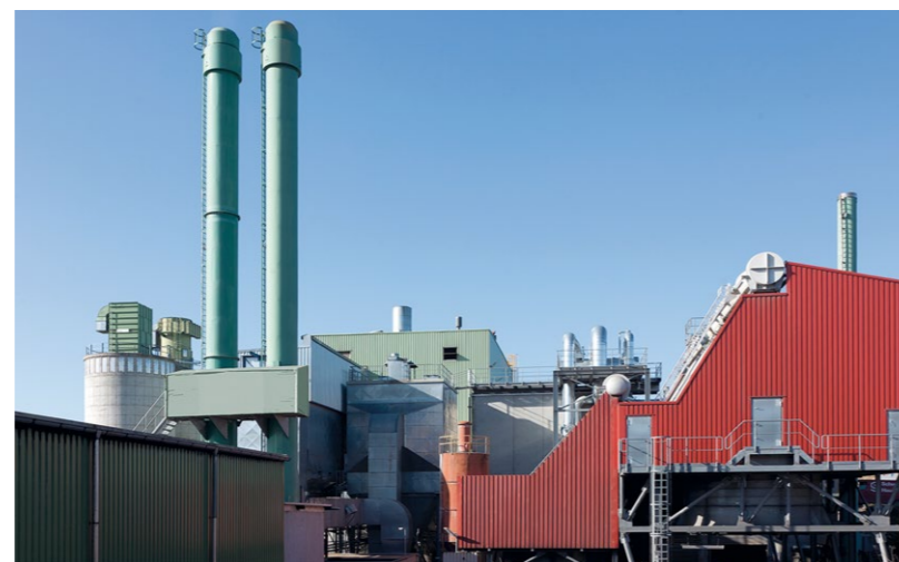
Biomassekraftwerk mit Wärmetauscher in der Abdampfleitung
