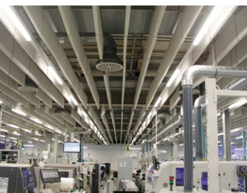
Beleuchtung für die Elektronikbestückung, Industriepark Karlsruhe
