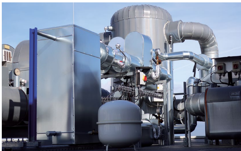
Kälteübergabe mit Wärmetauscher, Industriepark Karlsruhe
