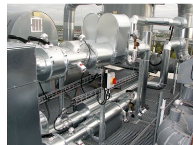
Einbindung Freikühlung in das Kältenetz, Industriepark Karlsruhe
