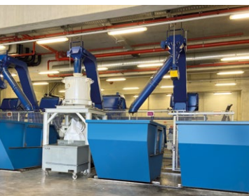
Metallspäne-Schredderanlage bestehend aus mehreren Einzelanlagen
