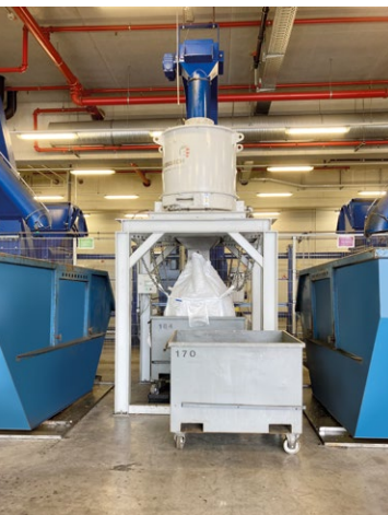
Schredderanlage mit Zentrifuge zur Abtrennung von KSS
