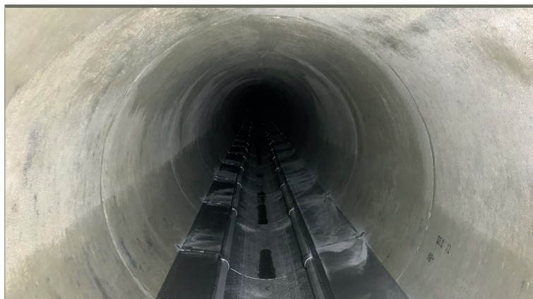
Kanalstrecke mit Wärmetauscher; Quelle: Ing. Büro Bürkle
